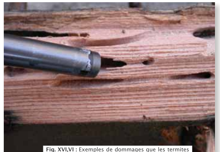
Fig. XVI,VI : Exemples de dommages que les termites peuvent faire subir au bois. L'image ci-dessus montre du bois mangé par des termites de bois sec. (VRL)
